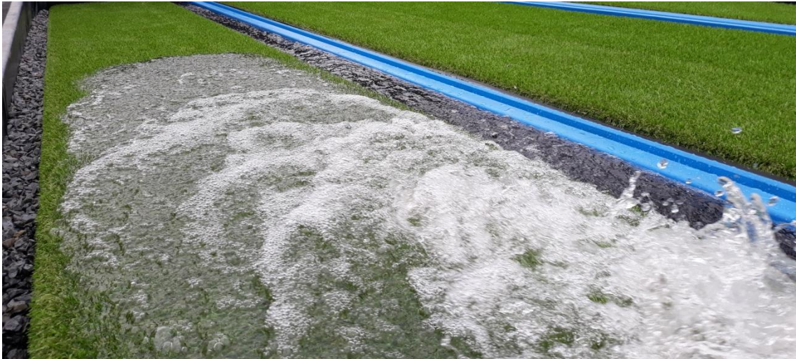
ŘÍZENÉ ZADRŽENÍ DEŠŤOVÉ VODY V PROSTORU KOLEJE - OVĚŘENÍ VSAKOVÁNÍ VODY - zdroj: archiv BRENS EUROPE, a.s.
